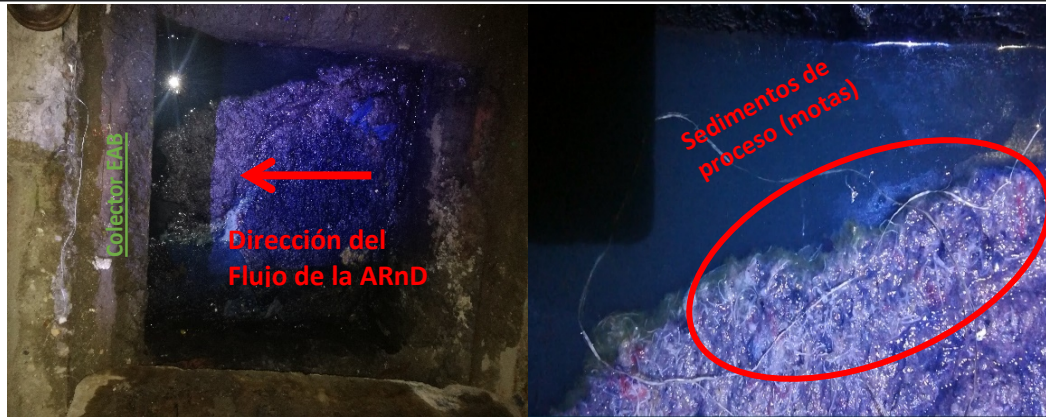
Foto No. 5. Caja de inspección KR 13F 58 25 SUR
