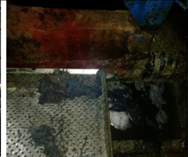
Foto No. 4. Caja interna/ rejilla de control de solidos
